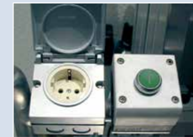
Stromversorgung im Arbeitskorb
